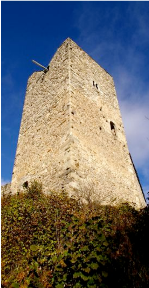
Der Bergfried, von Westen, aus dem Burggraben gesehen. Das Rohr oben ist Teil einer moderne Traufanlage.
